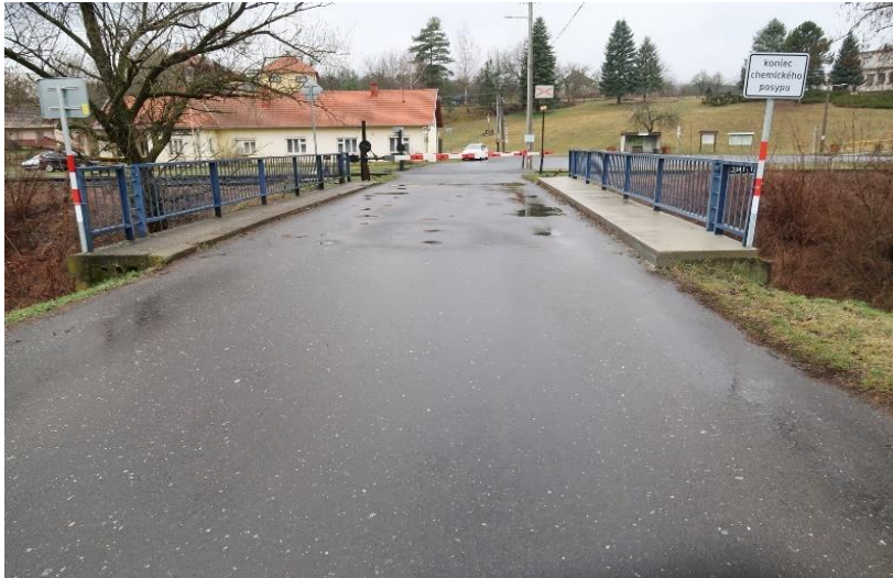
M1281, evid. č. 2660-001_Most cez bezmenný potok v obci Mašková – oprava ríms
